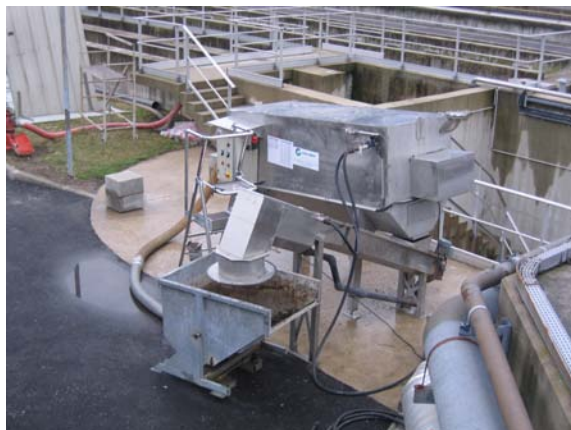
Photo 4 : poste prétraitement spécifique des matières de vidange
