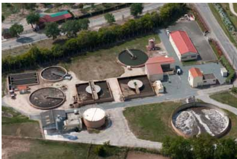
Station de traitement des eaux usées
