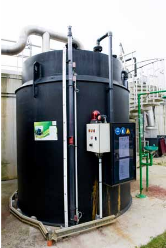
Cuve pour traitement du phosphore
