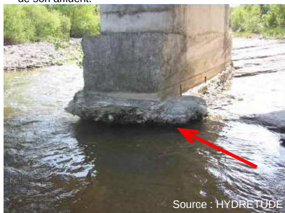
Photo 3 : L'Ouvèze à Rompon (Ardèche) : pont déchaussé par blocage du transport sédimentaire.
