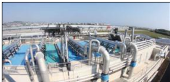
Station d'épuration Aquaviva 2012 300 000 eq hab Ultrafiltration membranaire
