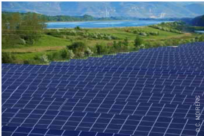
Parc photovoltaïque de Saulce-sur-Rhône (Drôme)
