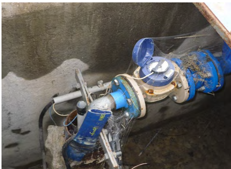
Compteur sur captage d'eau souterraine
