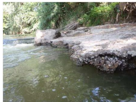
Seuil de la Bastide, affouillement rive gauche © SABA
