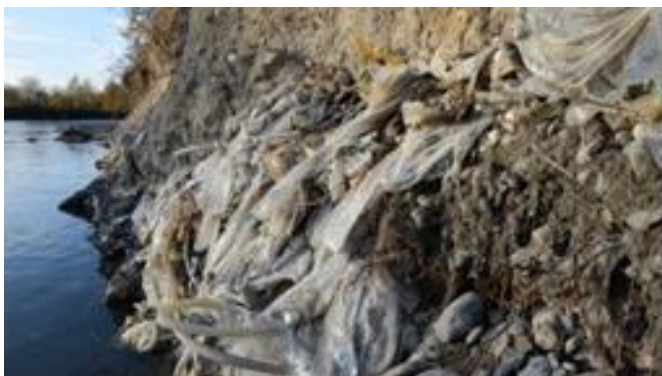
Décharge en berge mise à nu par l'Arve
