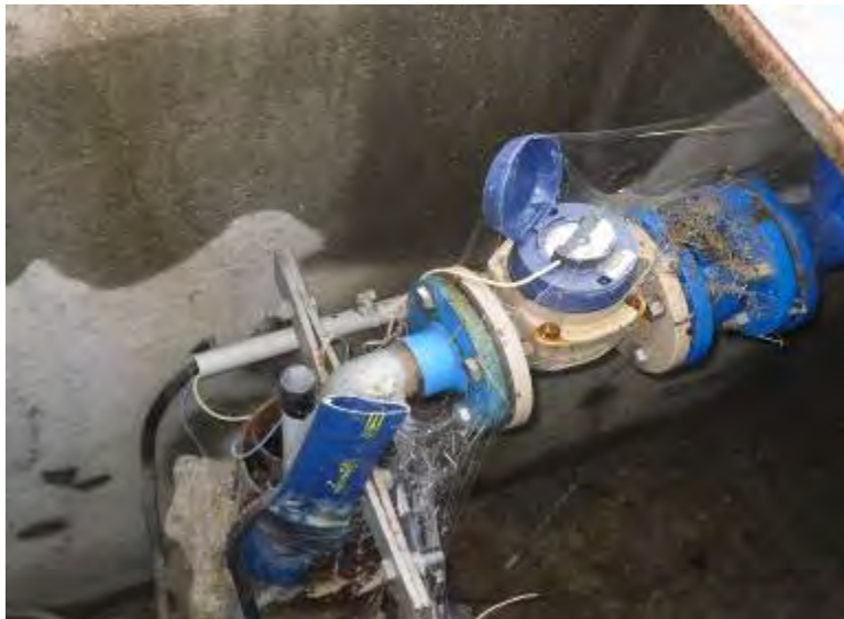
Compteur sur captage d'eau souterraine
