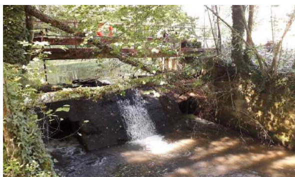
Ancien seuil dégradé © SVO
