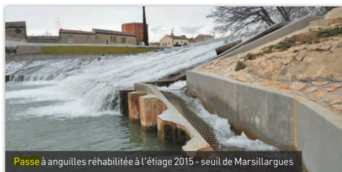
Passe à anguilles sur le seuil de Marsillargues © EPTB Vidourle
