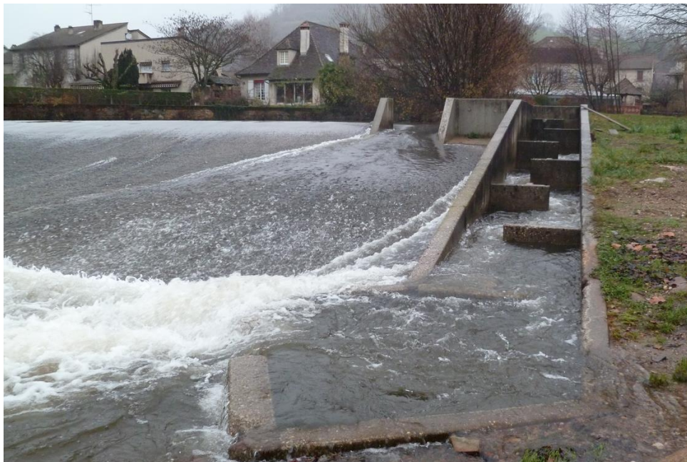
Figure 55 : Illustration d'une passe à poissons dont l'entrée et les premiers bassins à l'aval sont hydrauliquement non fonctionnels pour le franchissement piscicole lors du passage d'une éclusée (©ECOGEA)
