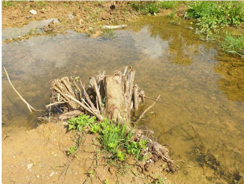
Figure 8 : Souches réimplantées dans le nouveau lit pour diversifier les écoulements et maximiser la reprise des processus morphologiques
