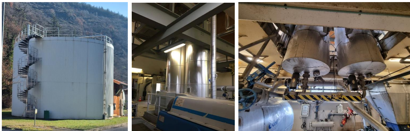
Photos – STEU du Pertuiset à Unieux – Gauche : digesteur – 2 photos de droite : procédé par hydrolyse thermique
