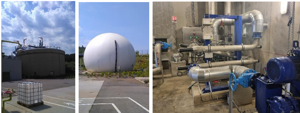
Photos – STEU de Vienne Sud – De gauche à droite : digesteur, gazomètre, procédé électrocinétique
